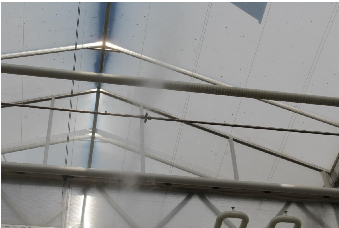
(párásító rendszer üzembe helyezése a szegvári palántanevelő üvegházban)
